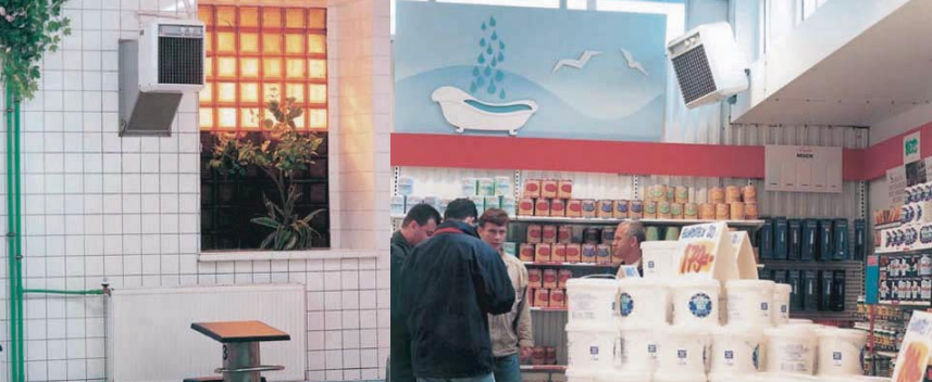
Nagrzewnice Pantera z komorą mieszania na basenie.
